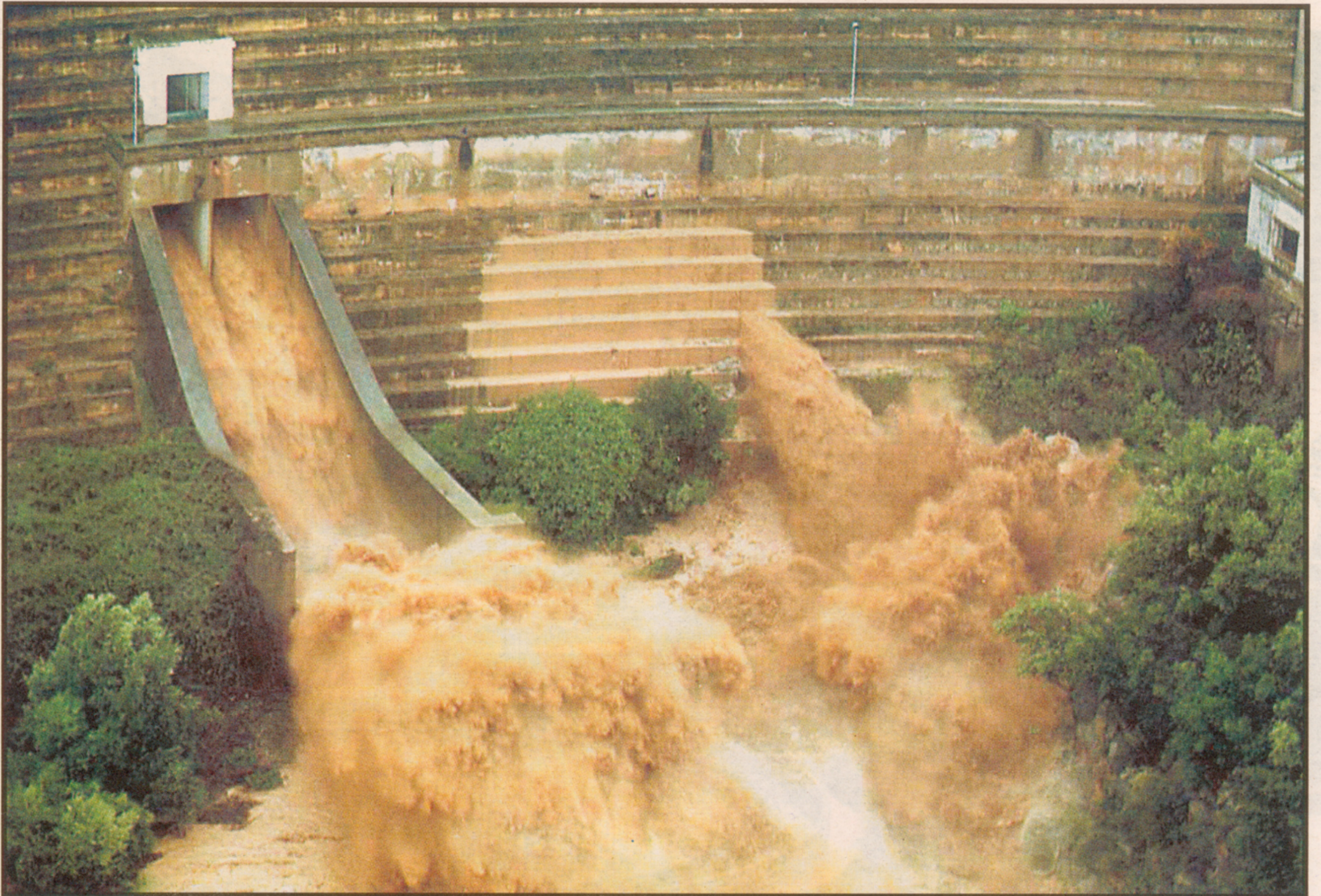
Presa de María Cristina. El temor a la rotura obligó a abrir las compuertas de la presa, que mostraba una grieta en su muro de contención.
